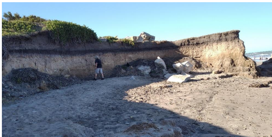
Ejemplo de derrumbes ocasionados por el peso de los bloques de piedra que apoyan en los bordes de los barrancos.
